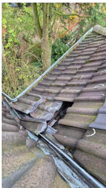
Waschbäreneingang im Dach (Foto: Privat)
